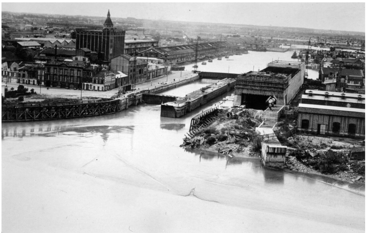
La construction de l'écluse fortifiée en construction (1944) ; à gauche les anciens bâtiments de l'usine Lesieur. (Mémoire de Bordeaux)
